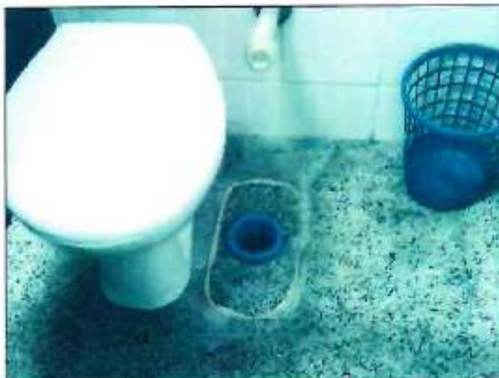
Imagem 17 - Vaso sanitário necessitado de reparo.
