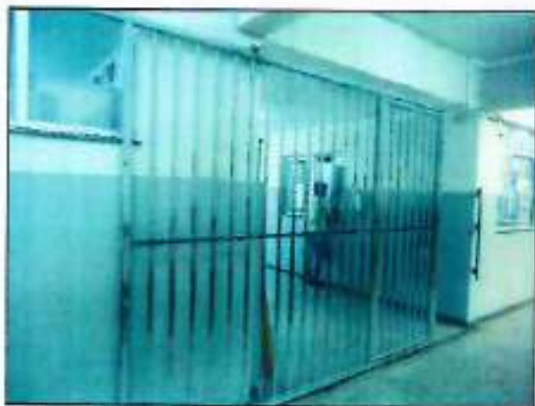
Imagem 9 – Portão necessitando de pintura.
