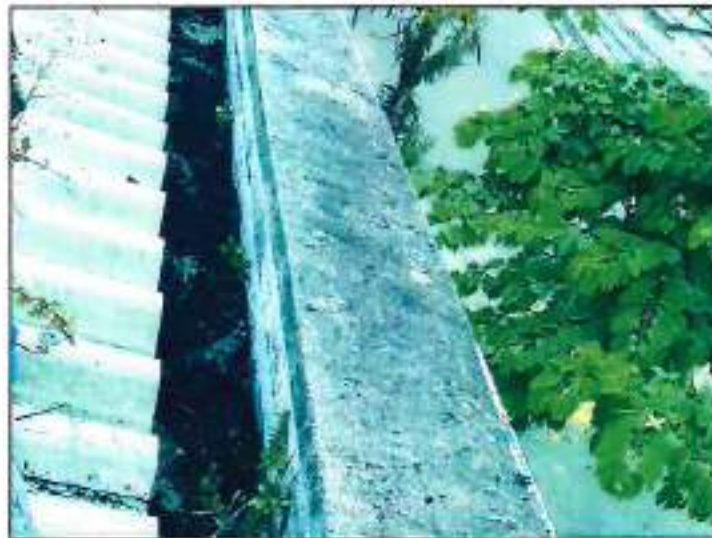
Imagem 24 – Calha necessitando de limpeza.
