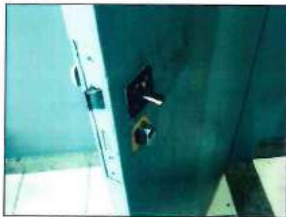
Imagem 3 – Fechadura com defeito.
