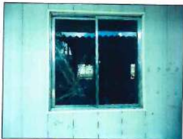
Imagem 38 – Vidro de janela quebrado.
