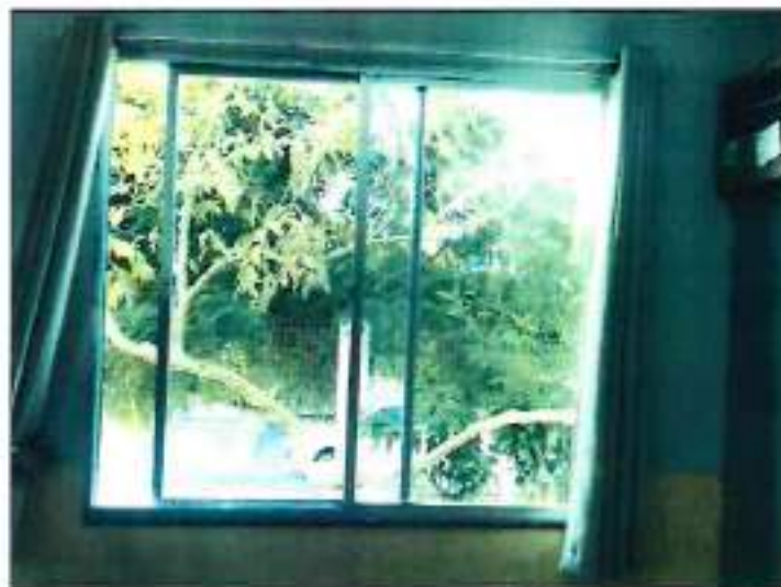
Imagem 25 – Janela de vidro faltando grade de ferro.
