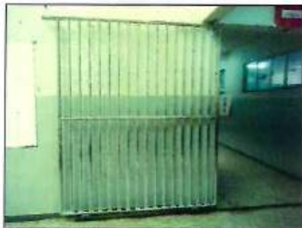
Imagem 10 – Portão necessitando de pintura.
