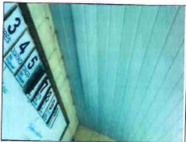
Imagem 26 – Forro com necessidades de reparo.
