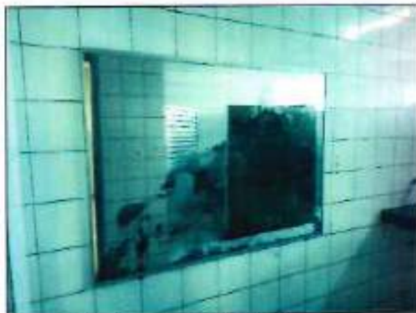
Imagem 12 – Espelho do banheiro necessitando de troca.
