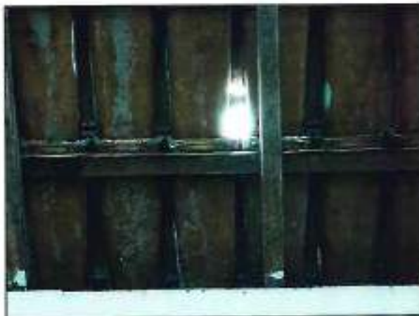
Imagem 22 – Telhas de cerâmica quebrada.
