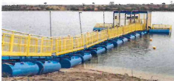
Captação de Água Lagoa Nova
