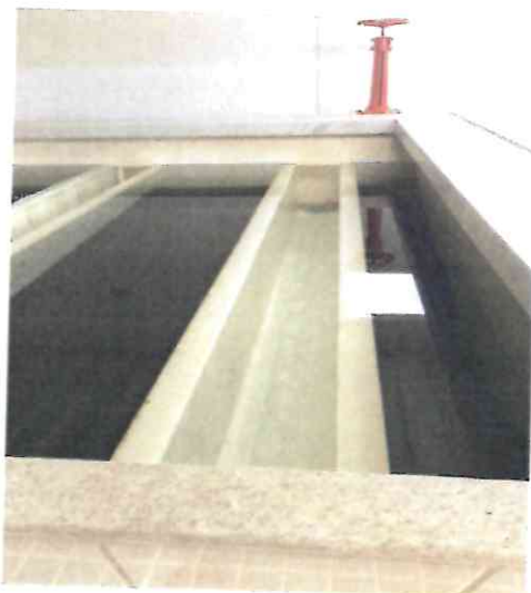
Vista dos Floculadores
