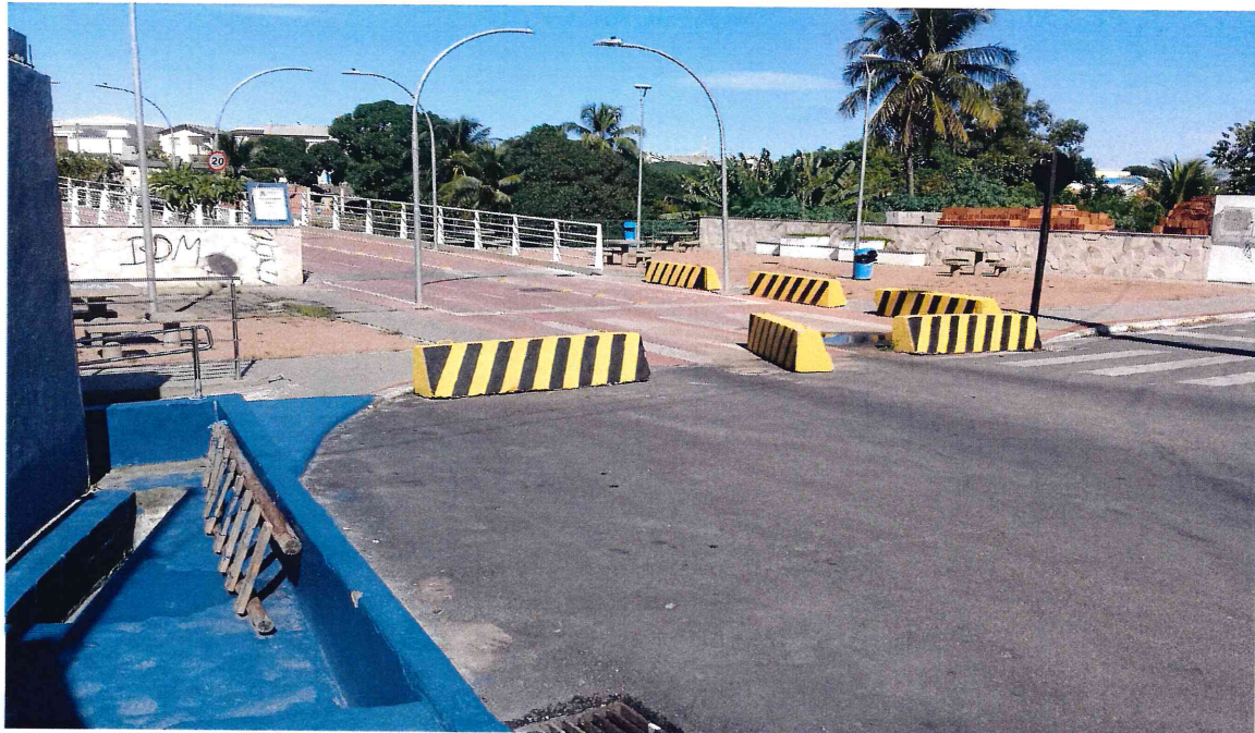
Foto 01 – vê aí o início da entrada na passarela saindo do Bairro São José indo para Bairro Palmital – distanciamento dos Prismas de Concreto
